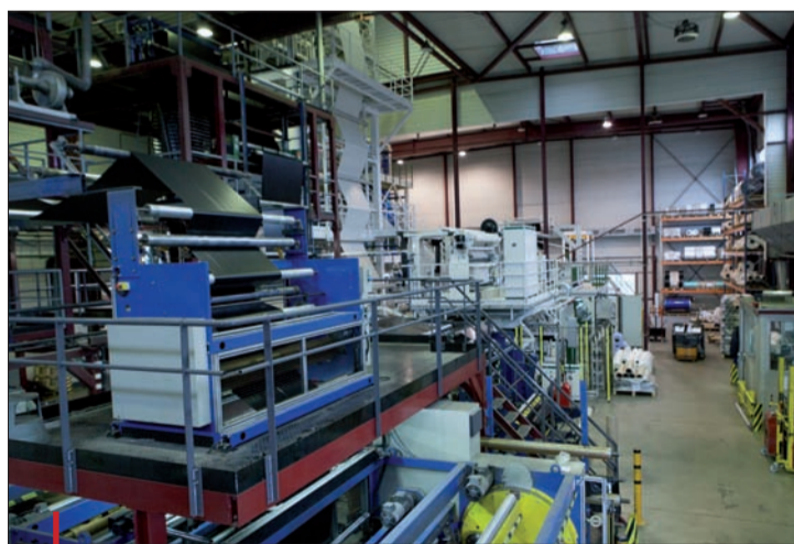
Le parc de coextrusion comprend trois lignes tricouches et une nouvelle ligne 5 couches.
